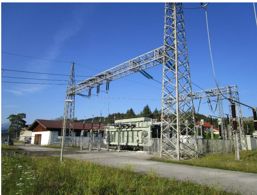
Abb. 5: Umspannwerk Krün mit Netzkuppeltransformator NK 1
